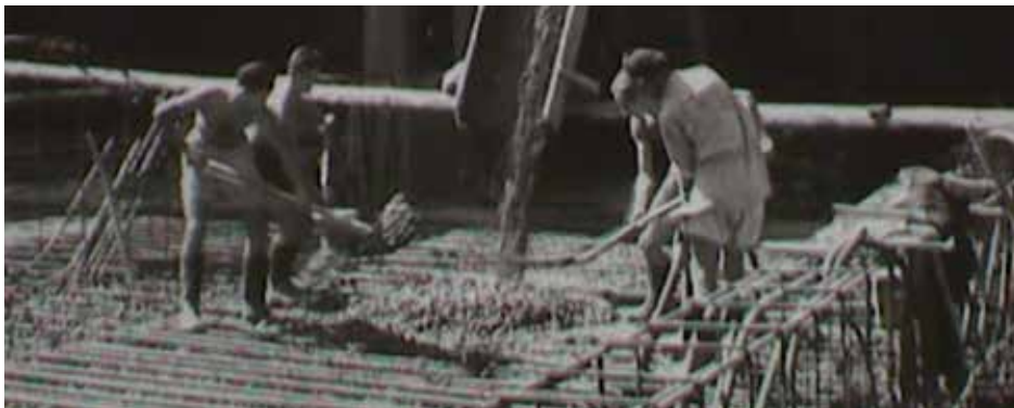
A metró építési munkálatai [Forrás: Magyar Filmhíradó 38; 1951. szeptember. 1951: Részvétel a metróépítésben, munkaversenyben] (Az eredeti forrásból a képeket készítette: Kenéz György)
